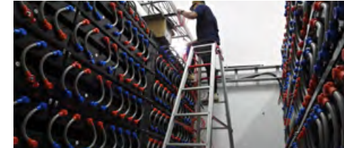
Oktober 2021: Die neue Solaranlage bringt uns dem Ziel näher, dass die Rettungsstation Samboja Lestari ohne fossile Brennstoffe auskommt.
